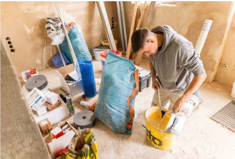
Gips, Mortel, Farbe: Solche Materialien gehoren zur Arbeitswelt von Jonas Schwarzwalder. Der angehende Stuckateur reinigt auf einer Baustelle sein Werkzeug. Philipp von Ditfurth/dpa-tmn
