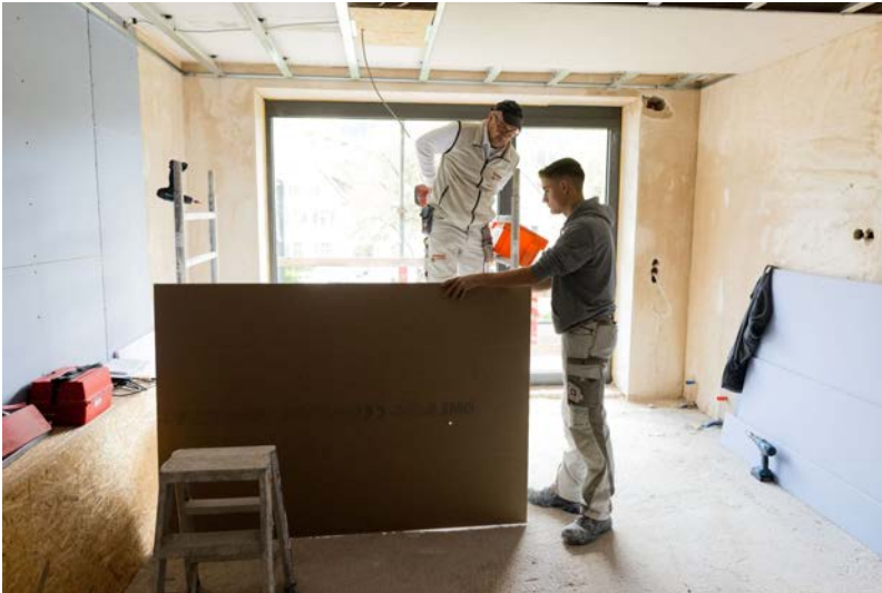
Jonas Schwarzwälder (r) und sein Ausbilder Egon Karl (l) arbeiten auf der Baustelle Hand in Hand. Philipp von Ditfurth/dpa-tmn
